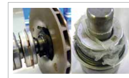
10.10 Nieprawidłowe zastosowanie materiału uszczelniającego
