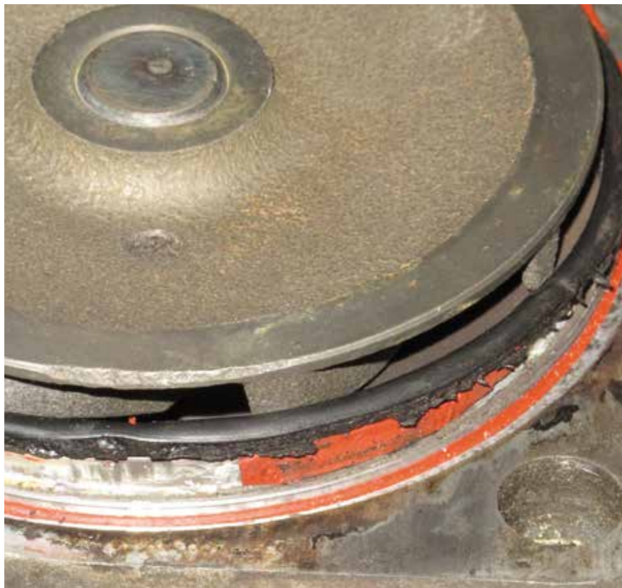
10.12 Pasta uszczelniająca niewłaściwie zastosowana do pierścieniowej uszczelki
