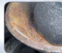
Rust Korrosionsunterwanderung Ruoste
