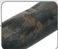
Damaged body Beschädigtes Aussenrohr Vahingoittunut runko
